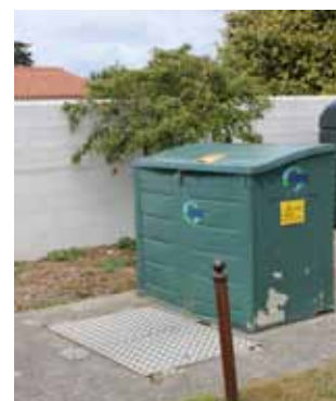
Poste de relevage de Saint-Sauveur
